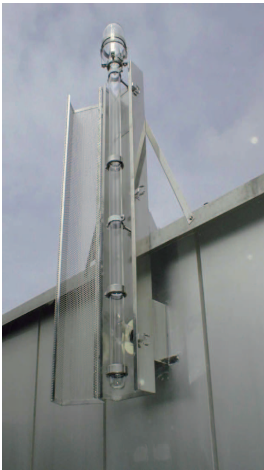
설치 예 (실외 배관)
