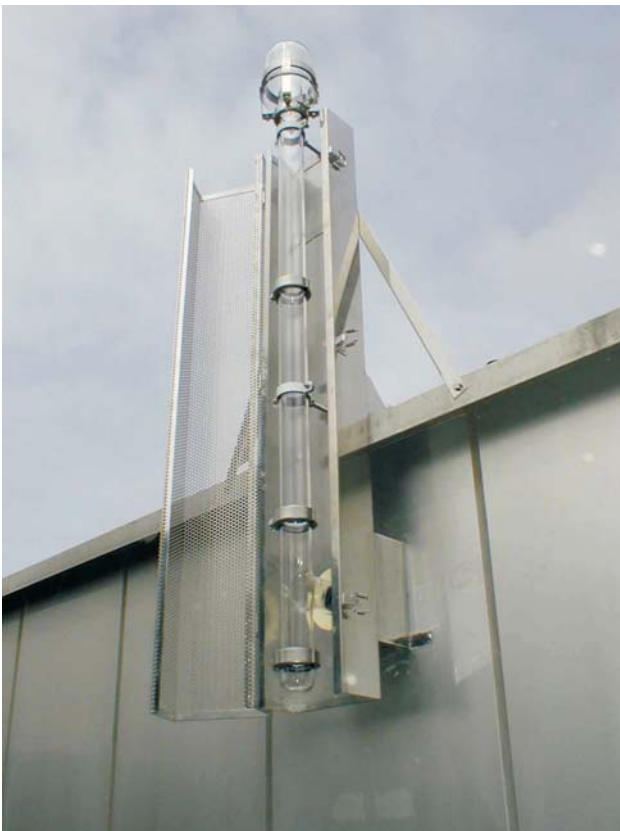
설치 예(실외 배관)
